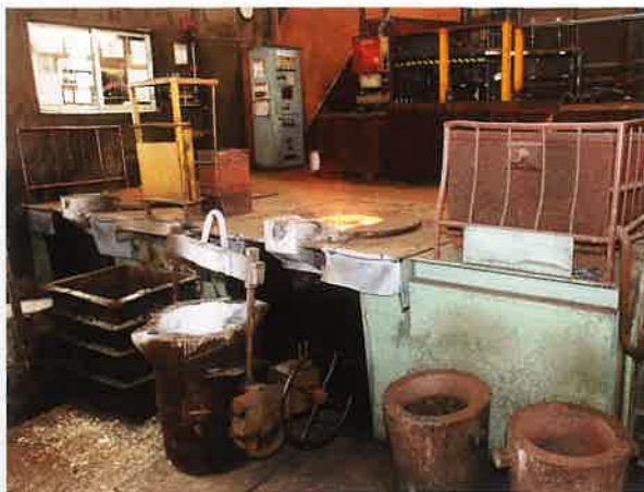
高周波溶解炉 1t 2台
