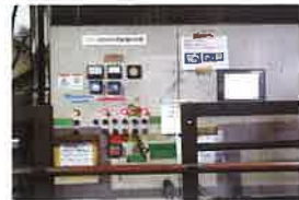
液晶パネルによる操作盤
